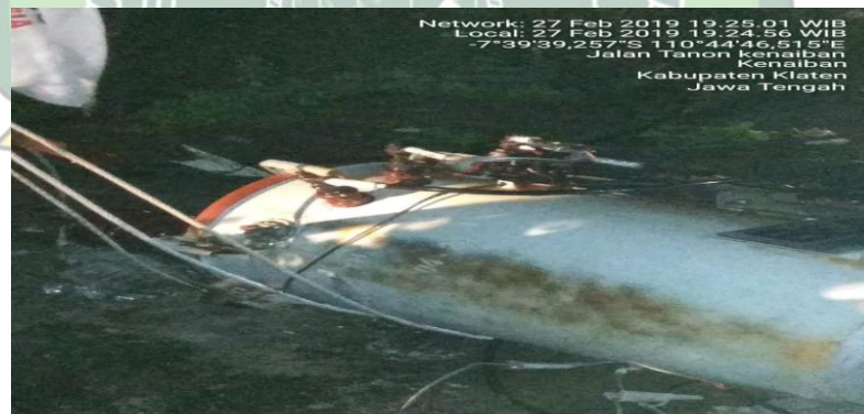
Gambar 4.5 Trafo yang rusak
