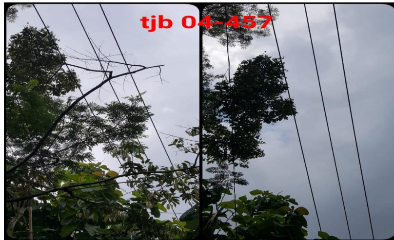
Gambar 4.1 Lokasi Terjadinya Hubung Singkat
